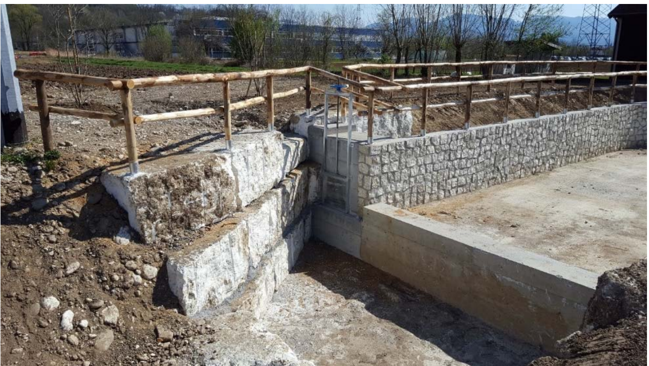
Figura 5-9 – Presa del canale di vivificazione presidiata da paratoia
